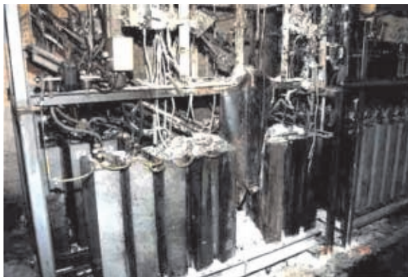
Brand in einer Kompensationsanlage
